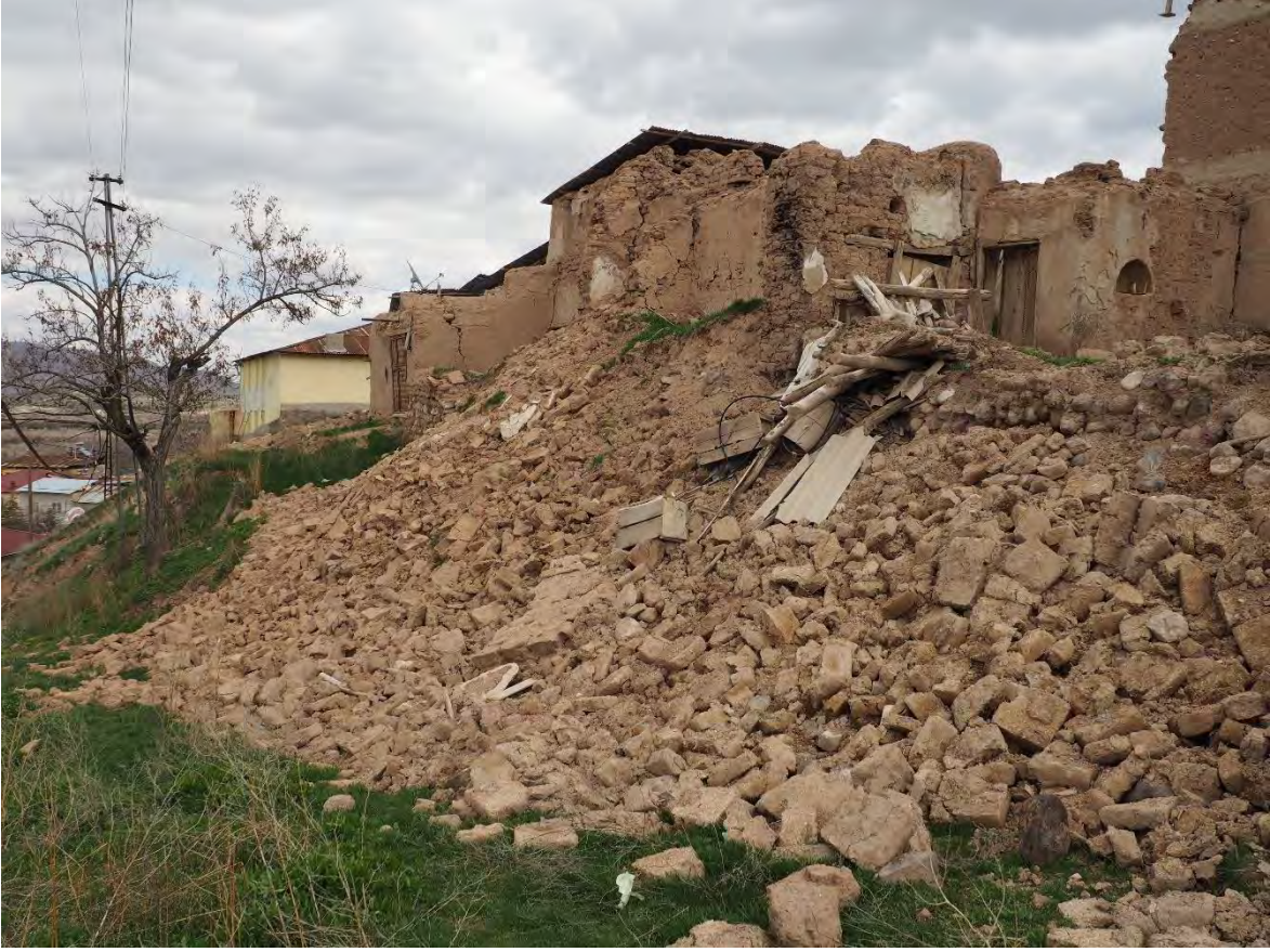
Balaban, duvarları yıkılmış yapı
