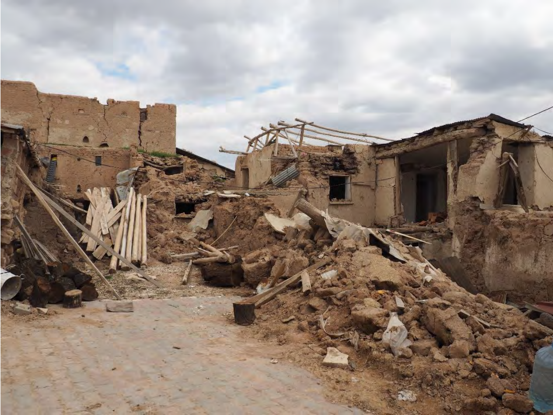
Balaban, ağır hasarlı kerpiç yapılar, kullanıcılar yıkılan yapıların ahşap kirişlerini toplayarak tekrar kullanmak ya da satmak için kenara diziyor
