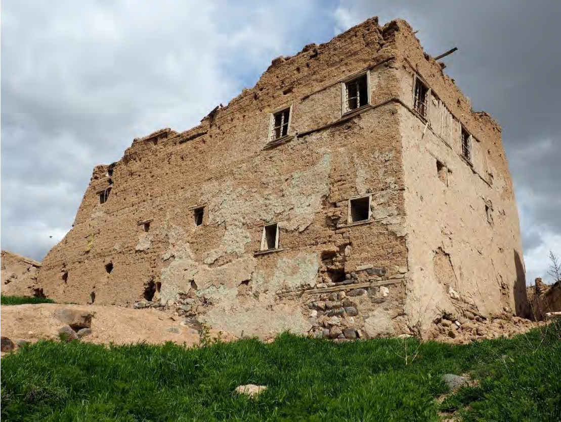
Balaban 2023; Deprem sonrası bir evin görünümü
