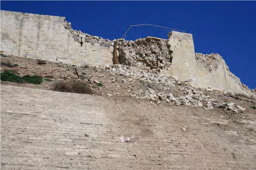
Gaziantep Kalesi burçlarında ve duvarlarında hasarlar
