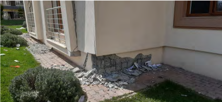
Betonarme Çok Katlı Yapılarda Hasar Detayları
