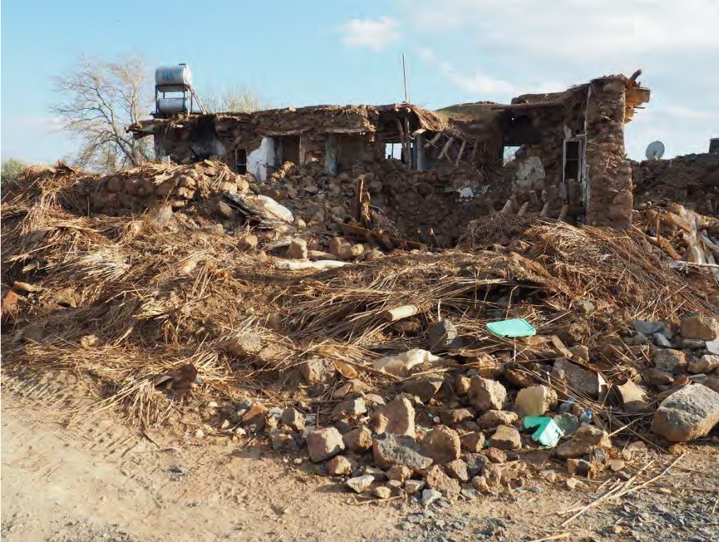
Gaziantep, İslahiye İlçesi, Zincirli Köyü, yıkılmış taş yapı
