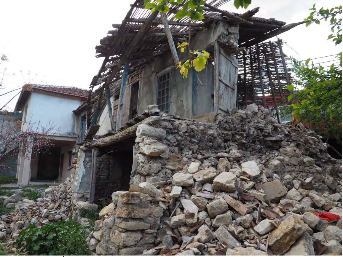
Hatay, Samandağ İlçesi, Hıdırlı Köyü, yıkılmış taş yapı
