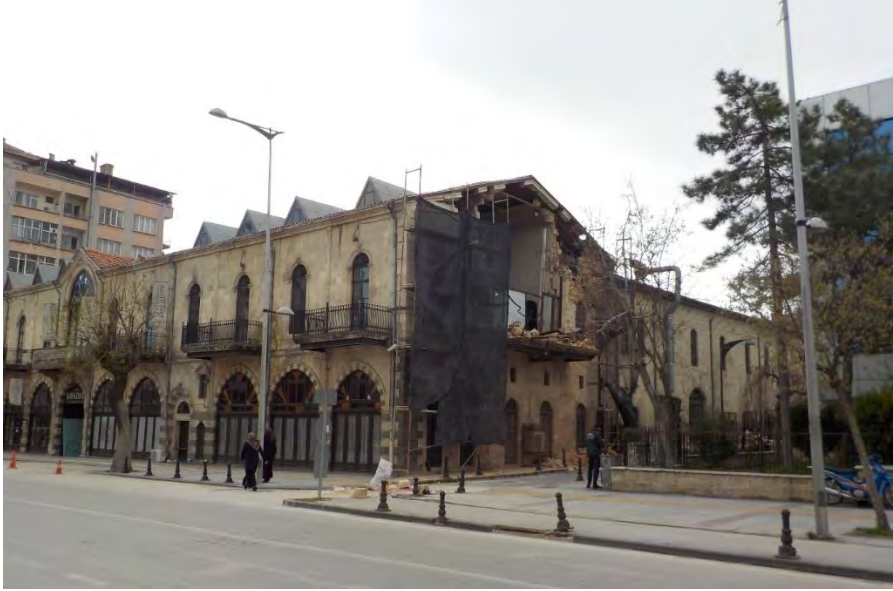
Beyaz Han, girişe göre sağ duvarının üst kat kısmı yıkılmış
