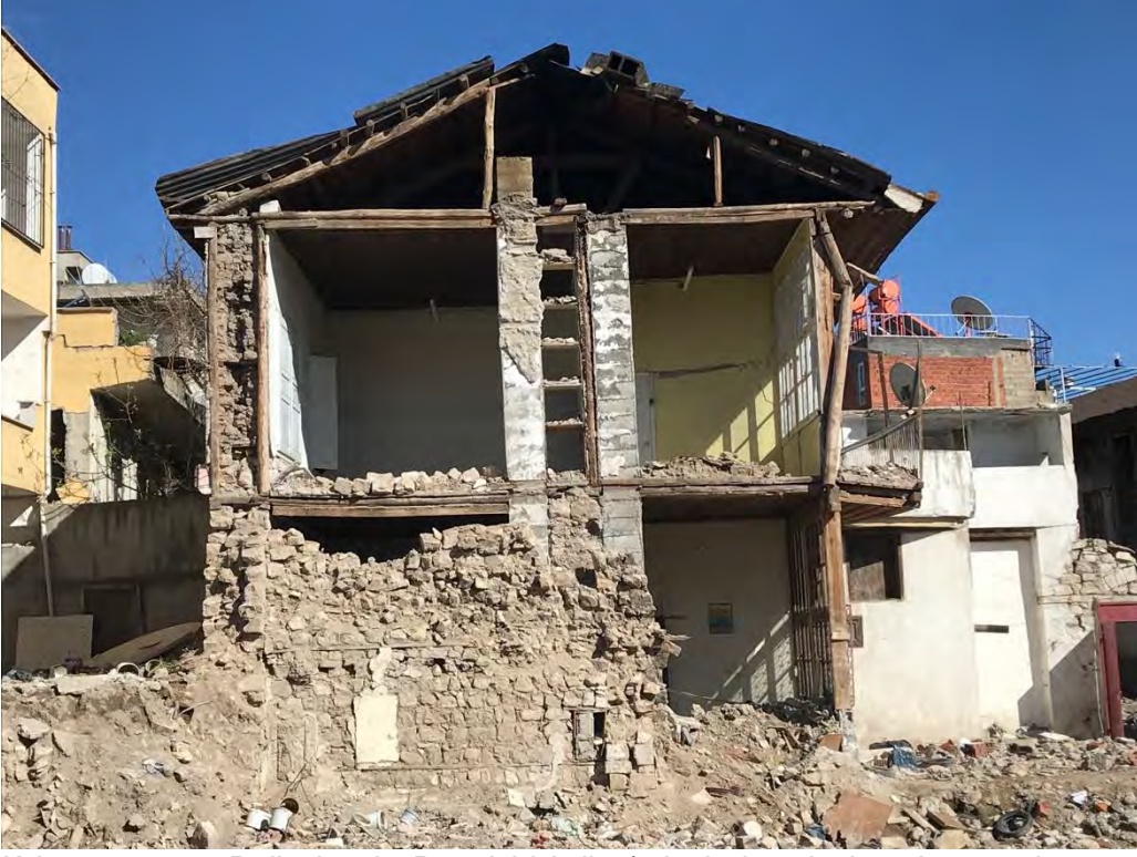
Kahramanmaraş, Dülkadiroğlu, Divanlı Mahallesi'nde düzlem dışı hasarlara örnek
