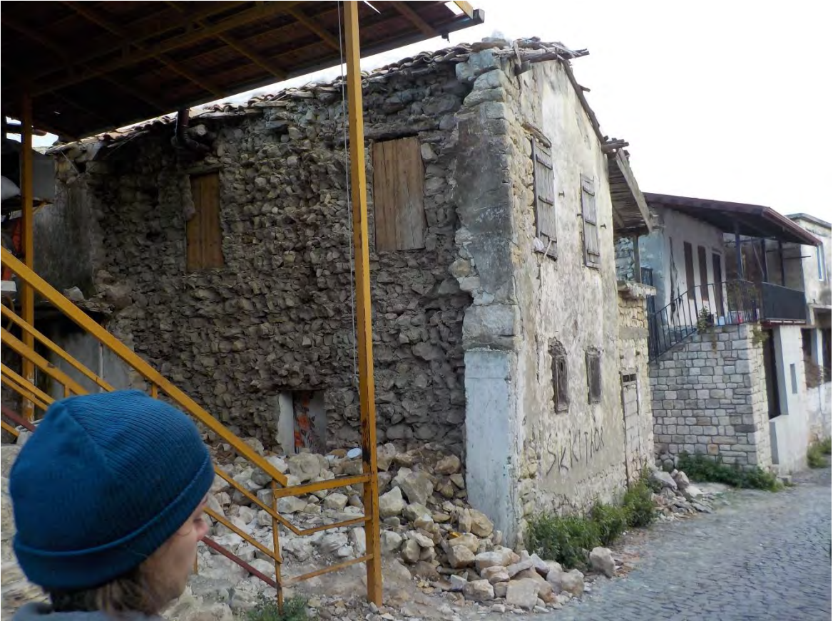
Hatay, Samandağ İlçesi, Hıdırlı Köyü dış cidarı dökülmüş taş duvar
