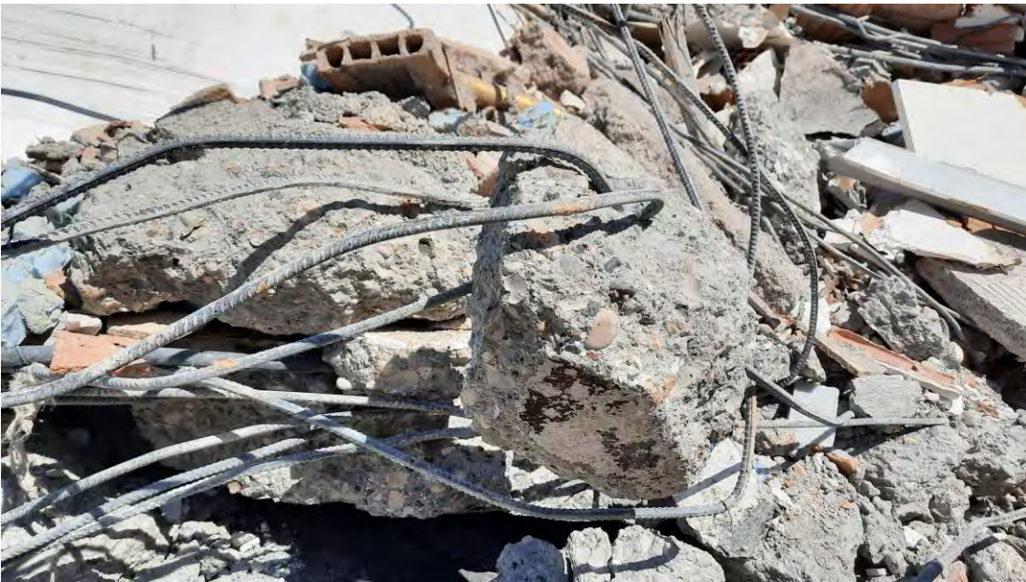
Adıyaman Altınşehir'de Yapısal Hasarlar
