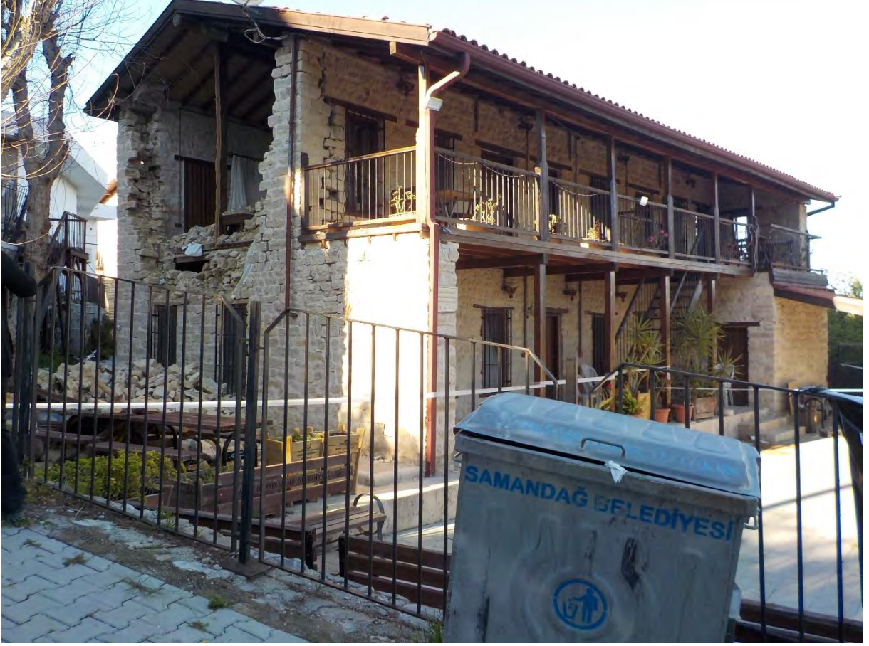
Hatay, Samandağ İlçesi Vakıflı Köyü restore edilmiş yapının yan duvarı yıkılmış
