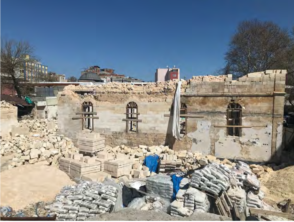
Adıyaman Çarşı Camii güney cephesinde kaplaması dökülen yeni duvar örgüsü
