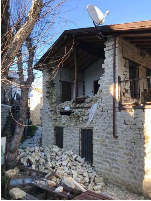
Hatay, Samandağ İlçesi, Vakıflı Köyü'nde düzlem dışı hasarlara örnek
