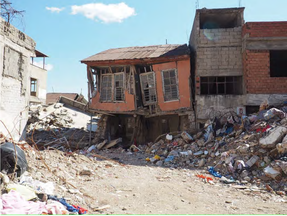
Kahramanmaraş merkez, zemin katı ahşap hatıllı yığma taş, üst katı ahşap karkas yapı
