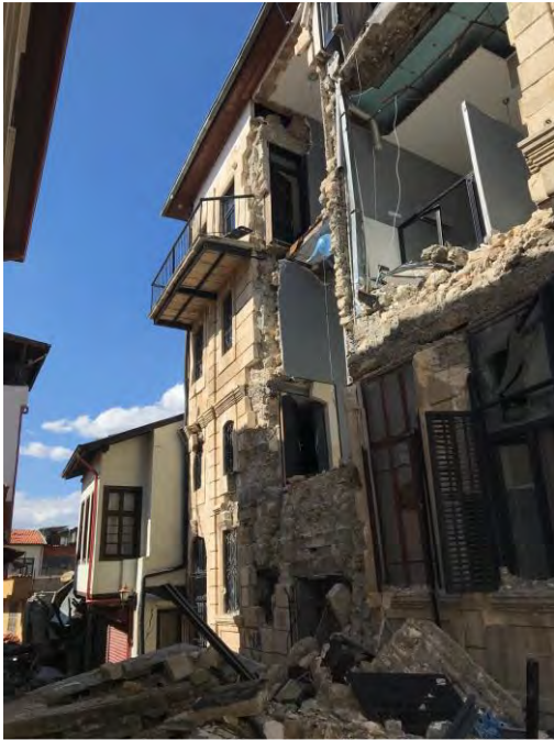
Antakya, Kurtuluş Caddesi'nde düzlem dışı hasarlara örnek
