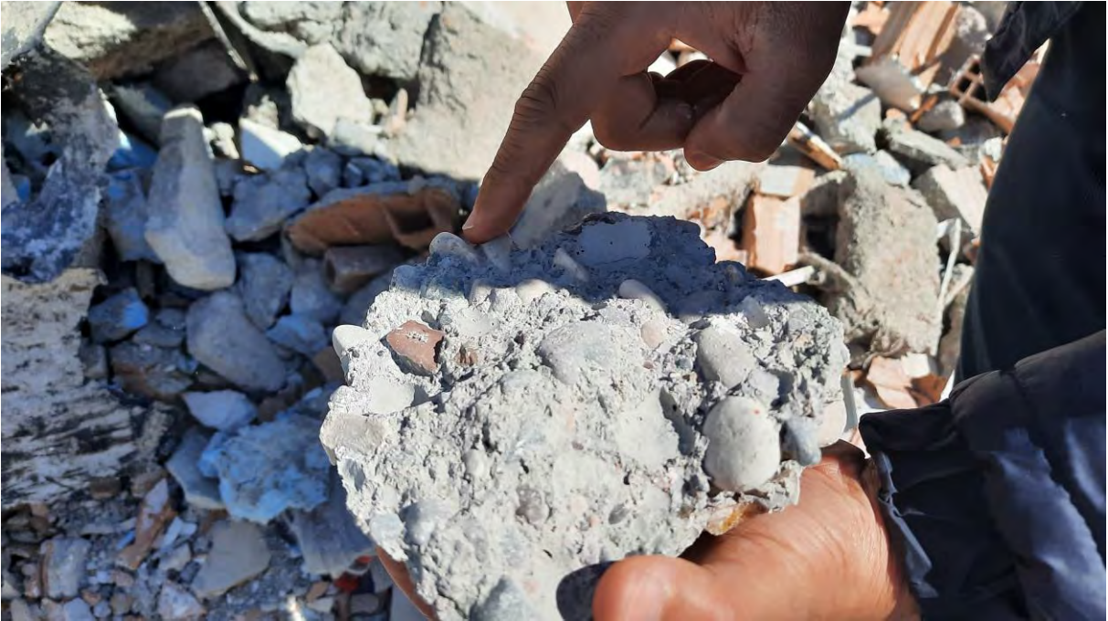
Yapısal Hasarlar, Beton ve Donatı Örnekleri
