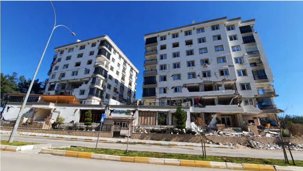
Malatya Bostanbaşı'nda Yeni Ancak Ağır Hasarlı Durumdaki Yapılar
