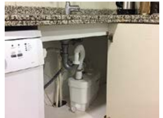
Tezgahın altına gizlenmiş Sanivite Pompa
